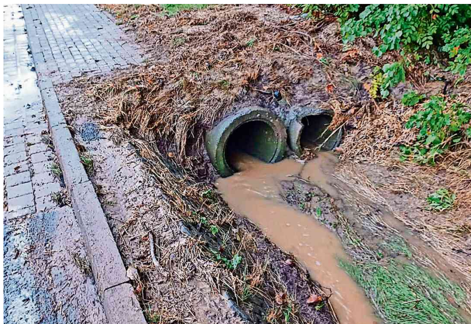
Zuvor schon verstopfte Entwässerungsröhre waren ebenso ein Hindernis für den Abfluss...
